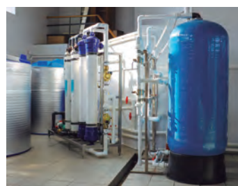
膜ろ過装置 各タンクのレベル計測
